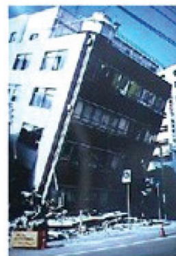
انهيار بسبب وجود رخاوة في الطابق الأرضي
