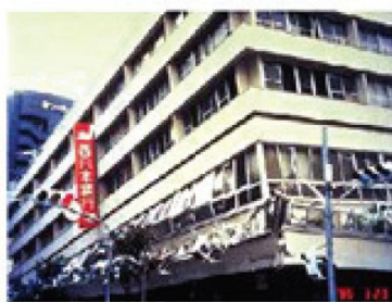
انهيار بسبب وجود رخاوة وضعف في الطوابق الوسيطة
