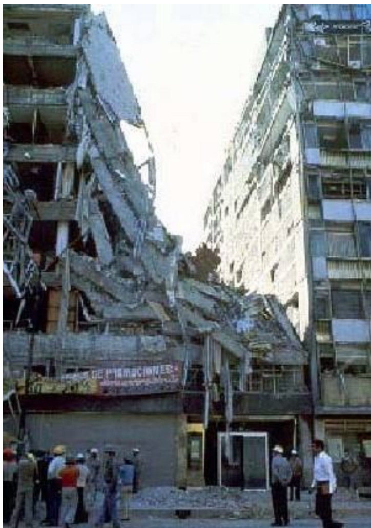
تلاصق المباني (عدم وجود فاصل زلزالي)
